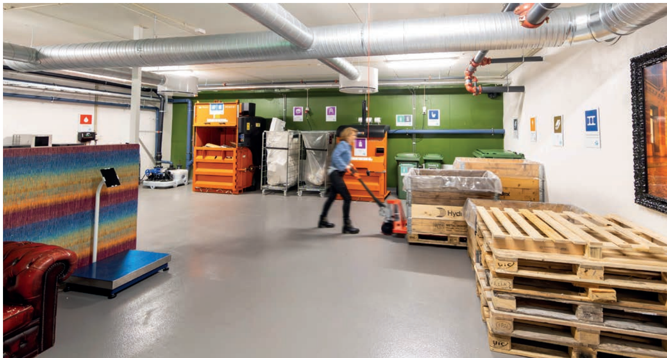
«Verdisentralen» i Veksthuset. Dette er avfallsrommet hvor avfall gjøres om til verdi for eiendommen og miljøet.
