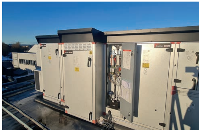
EC Blackbox fra Energy Control installert i styreskapet til ventilasjonsanlegget i Eikenga 11-15.
